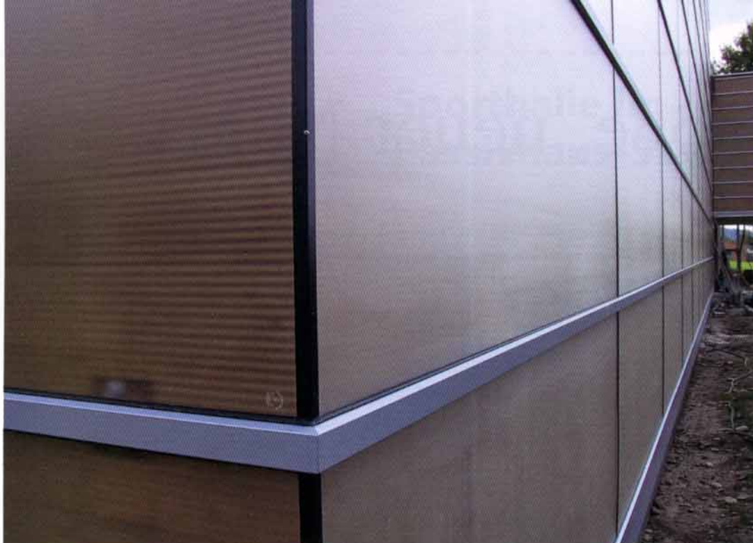
Eckverbindung der Lucido-Fassade. Die Lamellen der innenliegenden Holzelemente sind gut zu erkennen; sie erwärmen die Luft auf ca. 80 °C. Am Fußpunkt und Kopfpunkt der Fassade kann Luft einströmen bzw. entweichen
